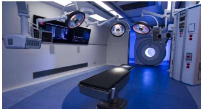
Figure 9 : Salle d'opération à Clinatéc
