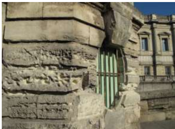
Photo 2. Attaque violente des calcaires gréseux et coquilliers avec lesquels on a construit les « Corps de garde » du Peyrou, à Montpellier, vers 1774. Sous la fenêtre, certaines pierres ont déjà été remplacées. Photo auteur.
